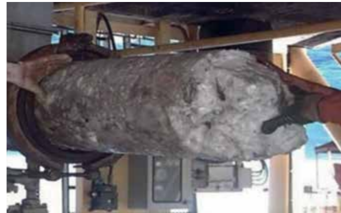
Рис. 4 Гидраты в трубопроводах
